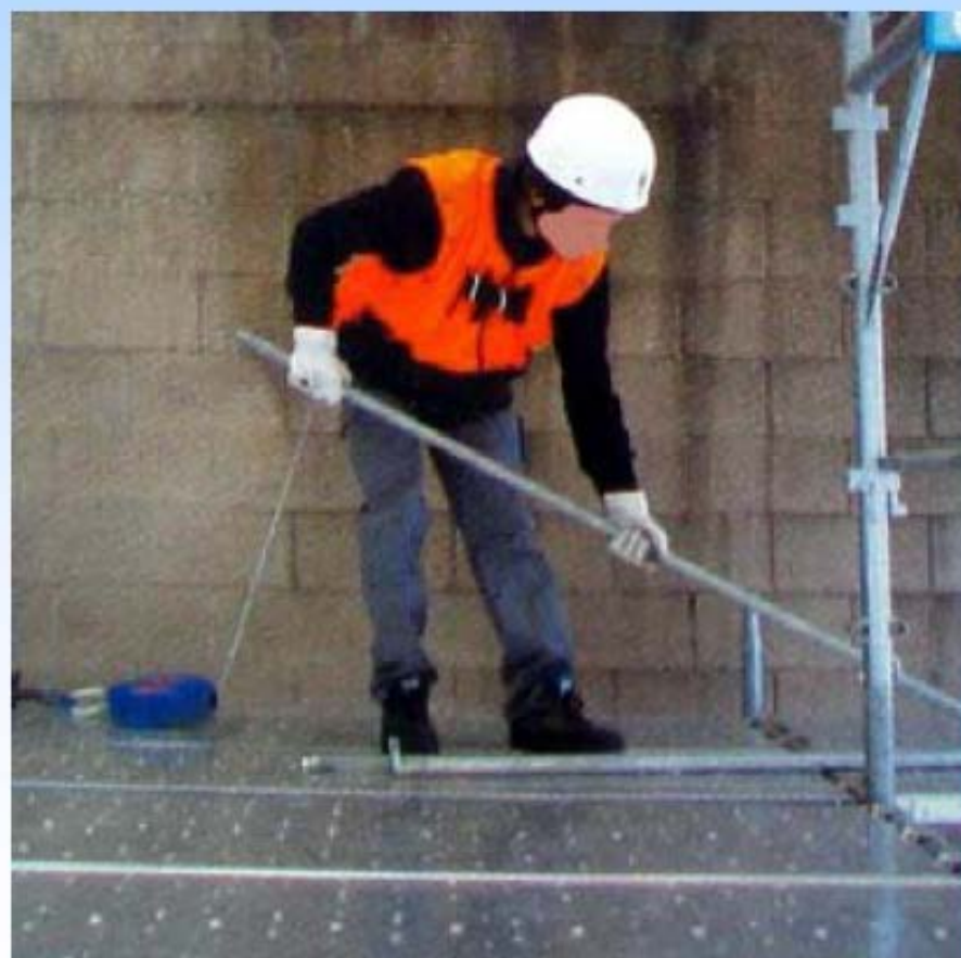
L'OPERATORE PUO' LAVORARE IN SICUREZZA
